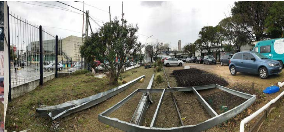
Vista del sector a intervenir desde el interior del predio ( esquina de las calles Alberdi y Curapaligüe)
